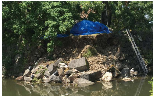
▲地震で崩落した八代城の石垣。余震が起きるたびに、崩れていった。
